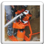
Carottage 90° sur tuyau d'assainissement. La carotteuse est coincée entre le tuyau et le blindage.
